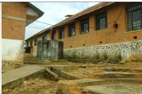
La jonction de la rampe, du caniveau et le perron à l'entrée entre la Pédiatrie et la maternité.
